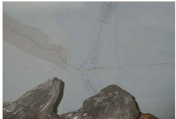
내부 지하층 벽체 균열 (CW=0.2mm, L=5.0m, 5EA)
