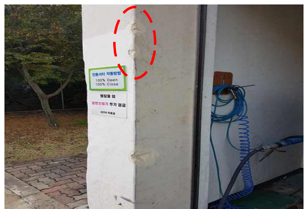
유입펌프장 외부 벽체 마감재 파손 (A=0.1m×0.1m, 2EA)
