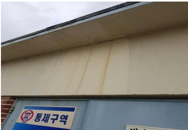
외부 벽체 누수흔적 (A=3.0m×1.0m)
