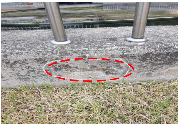
2지 외부 벽체 콘크리트 파손 (A=0.1m×0.1m)
