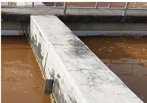
내부 벽체 균열 (CW=0.2mm, L=2.0m, 2EA)
