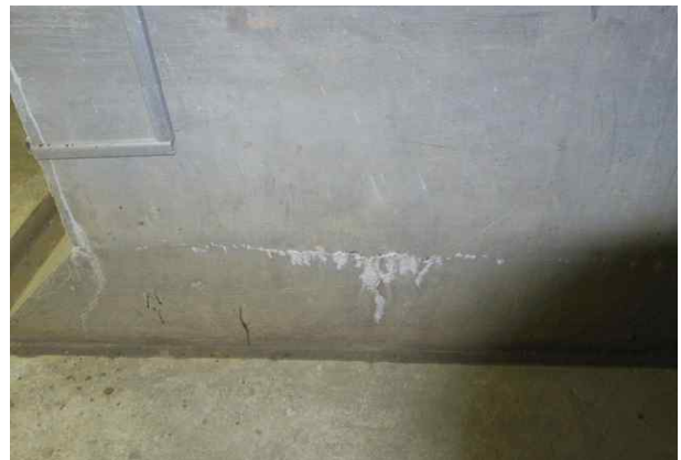
내부 지하층 벽체 균열 및 백태 (CW=0.2mm, L=2.0m, 2EA)
