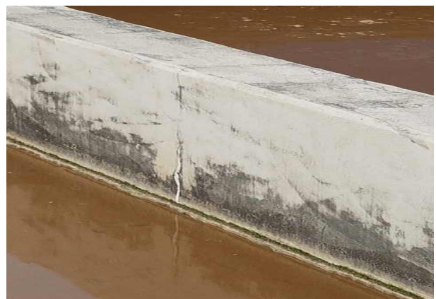
내부 벽체 균열 및 백태 (L=2.0m, 3EA)
