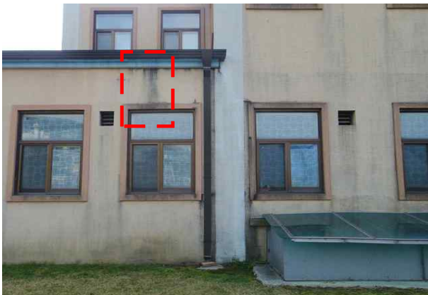
외부 벽체 누수흔적 (A=1.0m×4.0m)
