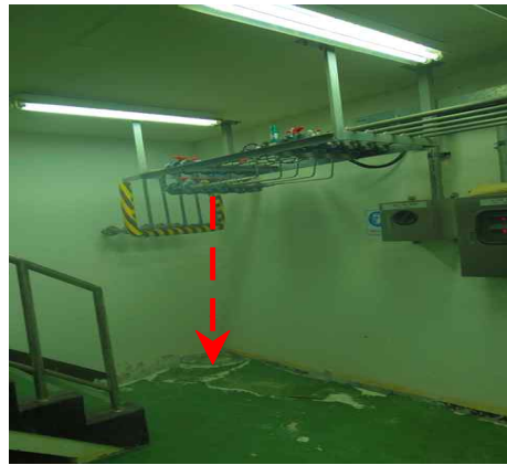
내부 지하층 바닥 박리 및 오염 (A=5.0m×5.0m)
