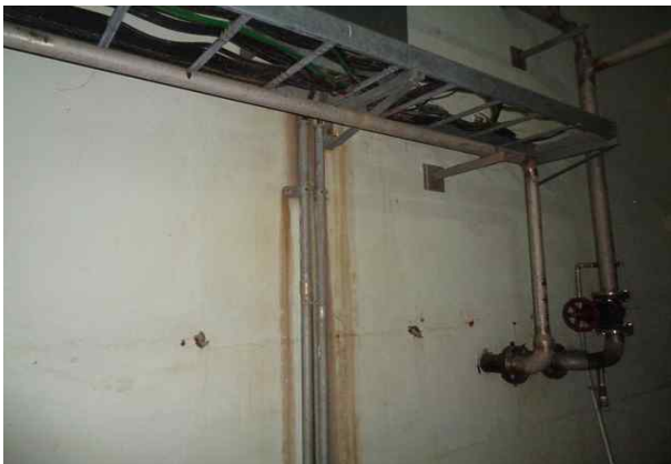
내부 지하층 벽체 누수흔적 (A=0.5m×3.0m)
