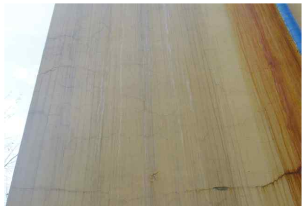
외부 벽체 마감 망상균열 (A=5.0m×5.0m)
