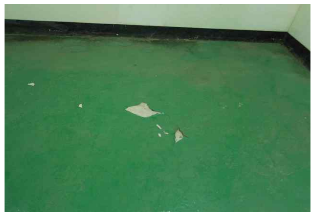
내부 지하층 바닥 도장박리 (A=1.0m×1.0m)
