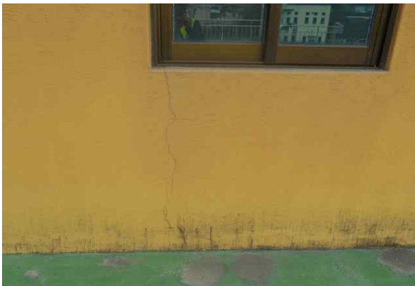
옥상층 벽체 마감 균열 (CW=0.3mm, L=1.0m)
