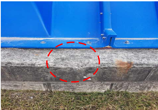
벽체 콘크리트 파손 (A=0.1m×0.1m)
