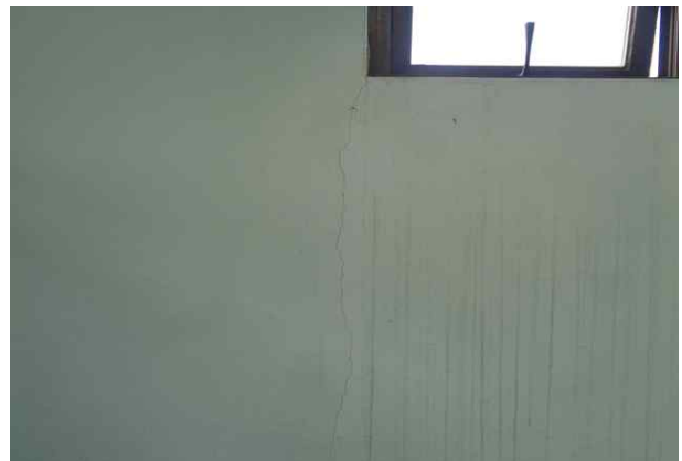
내부 벽체 균열 (CW=0.2mm, L=1.5m, 2EA)
