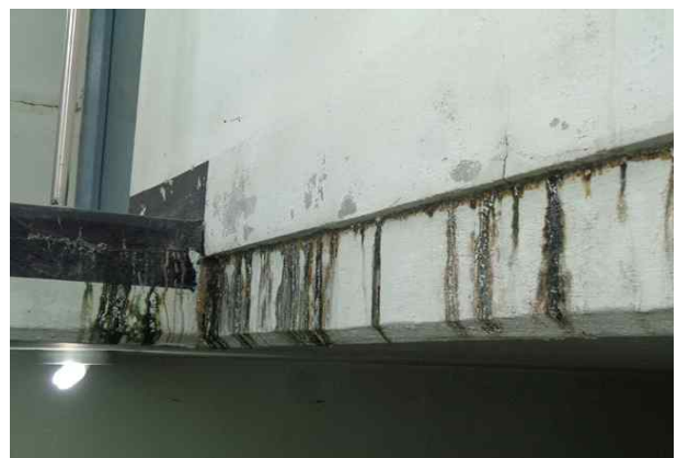
내부 벽체 누수흔적 (A=1.0m×0.3m)
