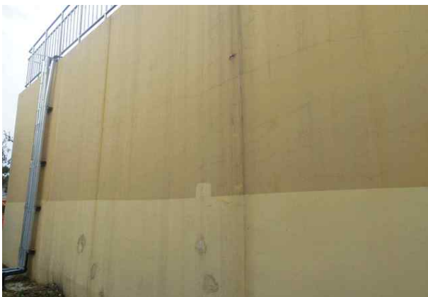
외부 벽체 마감 망상균열 (A=15.0m×5.0m)
