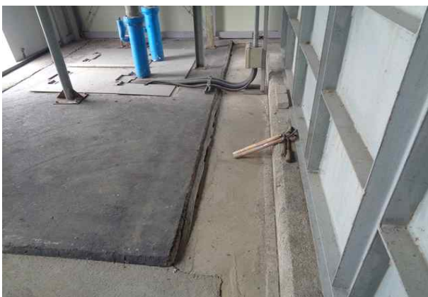
내부 바닥 실란트 파손
