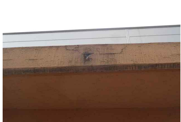
외부 벽체 마감재 파손 ( A=0.2\text{m} \times 0.7\text{m} )
