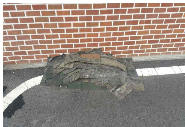
외부 옥상층 마감재 탈락 (A=5.0m×5.0m)
