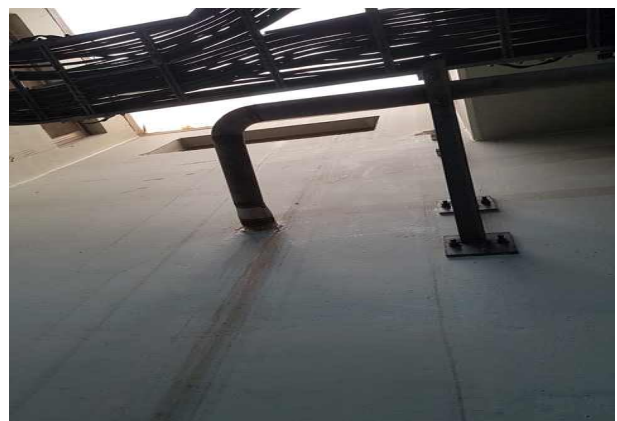
내부 지하층 벽체 누수흔적 (L=5.0m)
