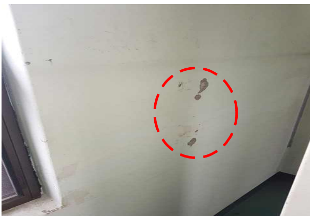
내부 벽체 콘크리트 박리 (A=0.1m×0.1m, 2EA)
