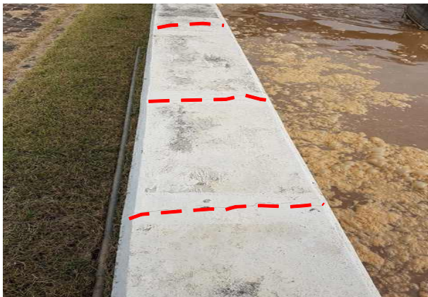
외부 벽체 상면 균열 (CW=0.2mm, L=1.0m, 16EA)
