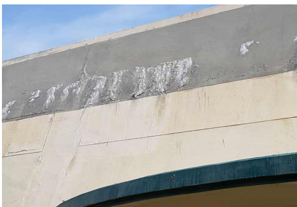
유입펌프장 외부 벽체 균열 및 백태 (L=12.0m)
