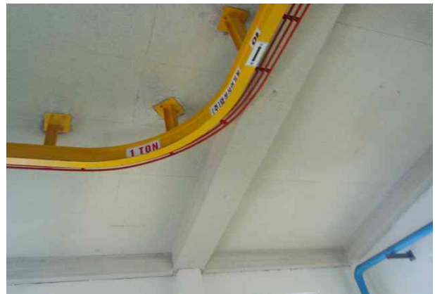
설비 천장 전경
