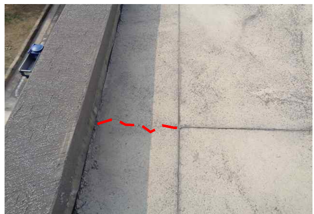
옥상층 바닥 균열 (CW=0.2mm, L=0.3m)
