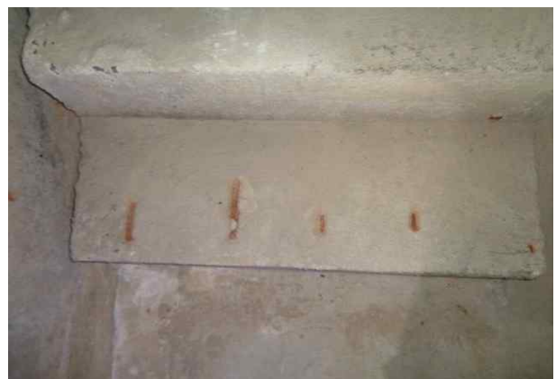
A-Line 바닥 계단부 철근노출 (A=0.1m×0.1m, 4EA)
