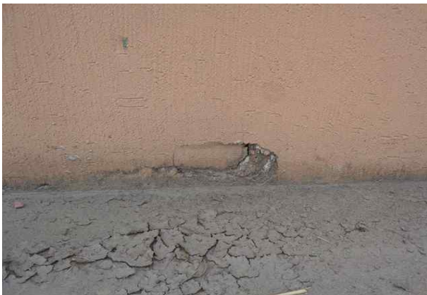
외부 벽체 마감재 파손 ( A=0.3\text{m} \times 0.1\text{m} )
