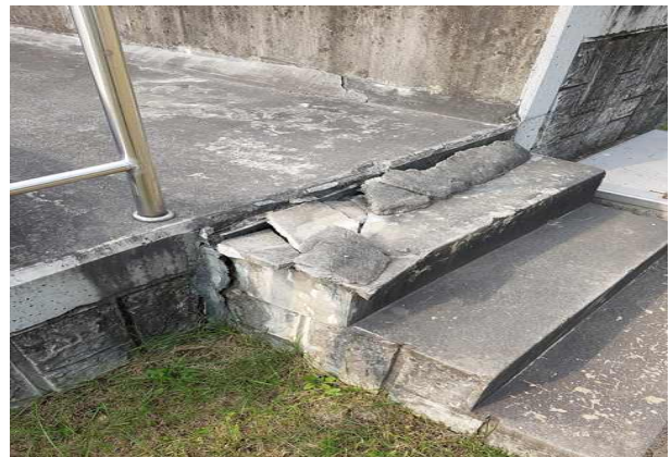
외부 계단 콘크리트 파손 (A=1.5m×0.1m)
