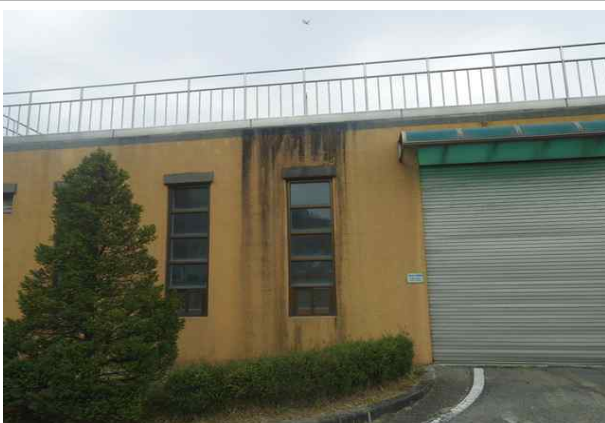
외부 벽체 누수흔적 (A=2.0m×5.0m)
