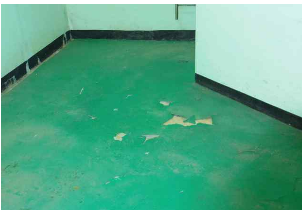
내부 지하층 바닥 도장박리 (A=2.0m×2.0m)
