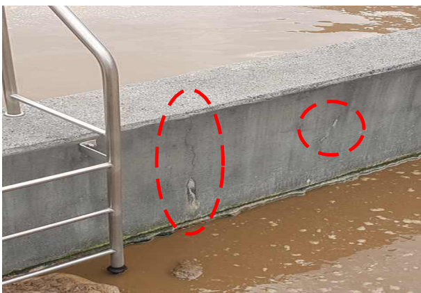
벽체 균열 및 백태 (L=0.5m, 2EA)
